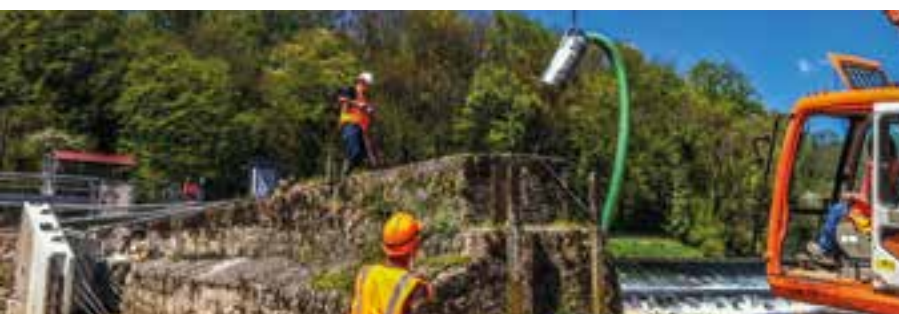
POMPES DE CHANTIER IMMERGÉES
