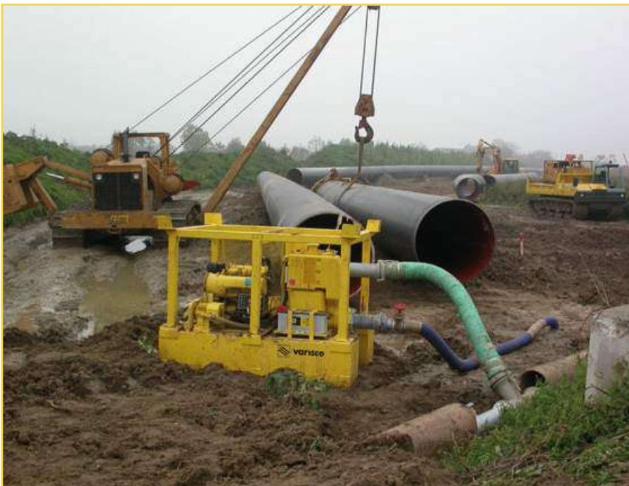
Drenaggio scavi per posa metanodotto Drainage des fouilles pour la pose de canalisation Drenaje de las excavaciones para puesta metanoducto
